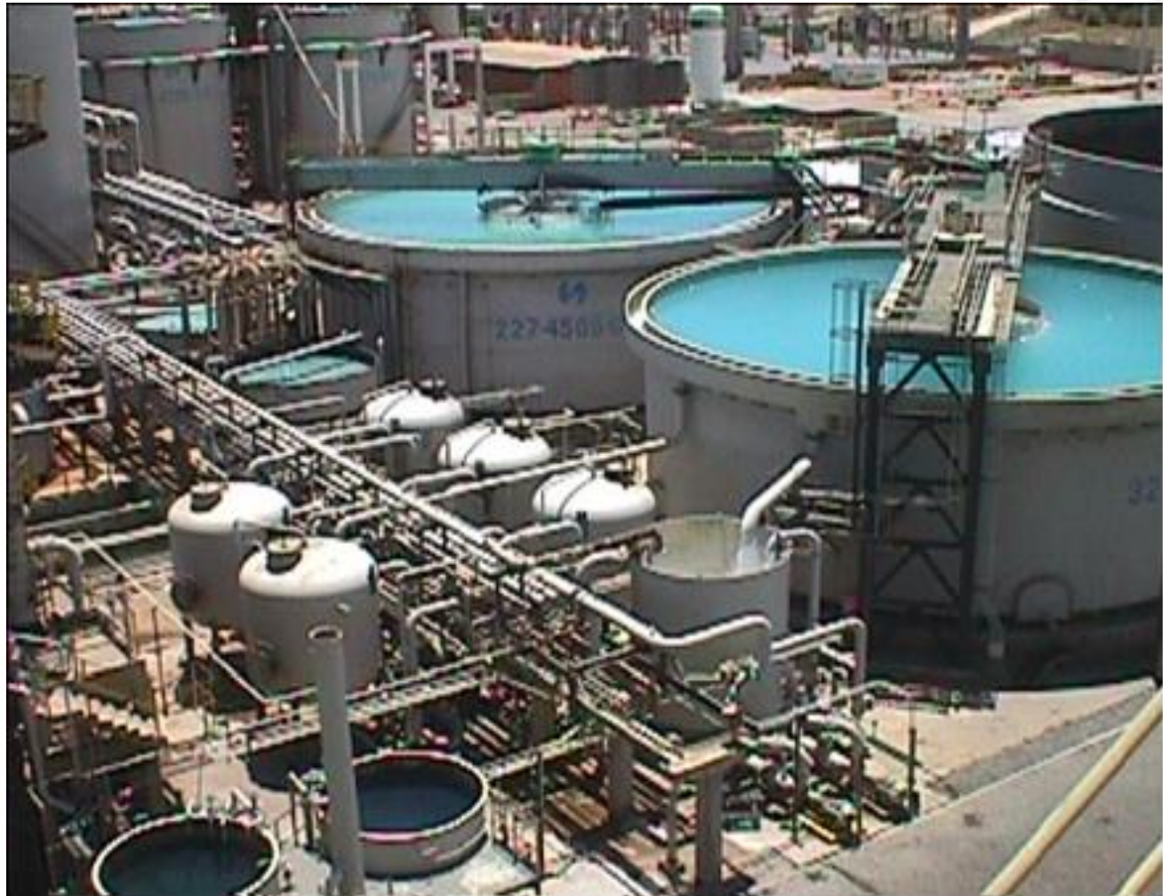
Decantador usado na Braskem Fonte: Braskem
